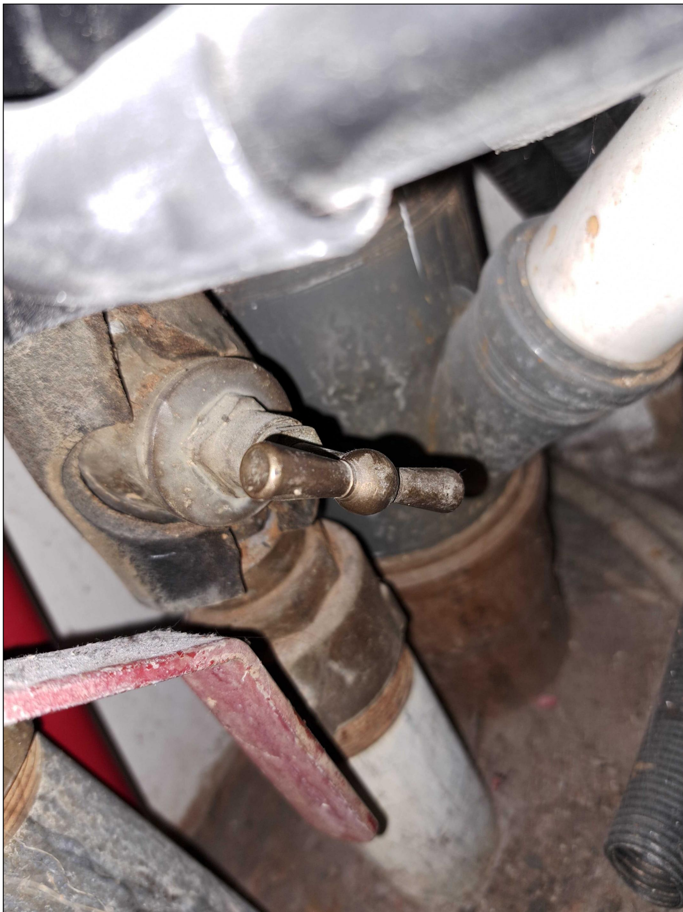
Eksisterende ventiltop på hoved-stophane.
